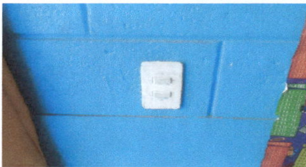
Foto 5: Apagadores para reparar
