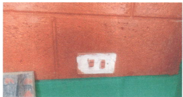
Foto 6: Tomacorrientes que reparar
