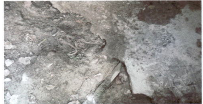
Foto 2: Estado de la losa del patio
